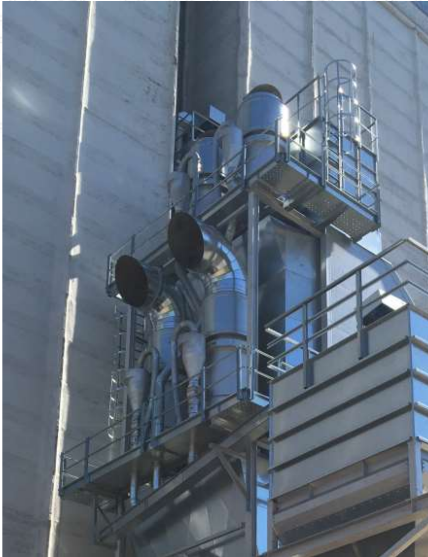
Foto. Kalte ar vertikāliem putekļu attīrīšanas ventilatoriem (Centrifani)
